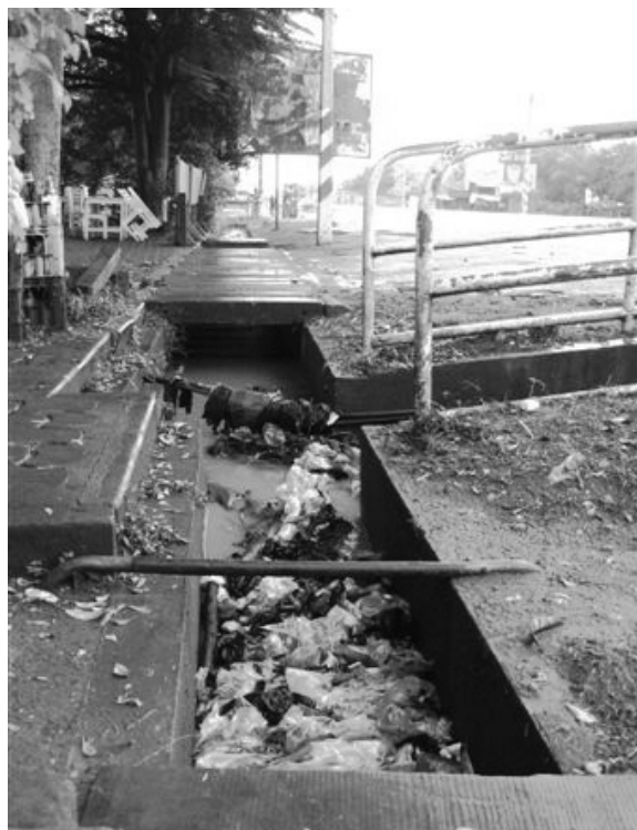
Abbildung 1: Zur Vermeidung von Gesundheitsrisiken für die Bevölkerung, von Schäden an der städtischen Infrastruktur und von hohen Umweltbelastungen sind angepasste Lösungen der Regenwasserbewirtschaftung erforderlich. Foto: Bamako, Mali. © Lettre du pS-Eau 62 de June 2010
