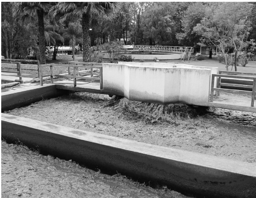
▼ Abbildung 3: Ökologischer Anspruch: privat betriebene Kläranlage in der Siedlung Bugambillas
