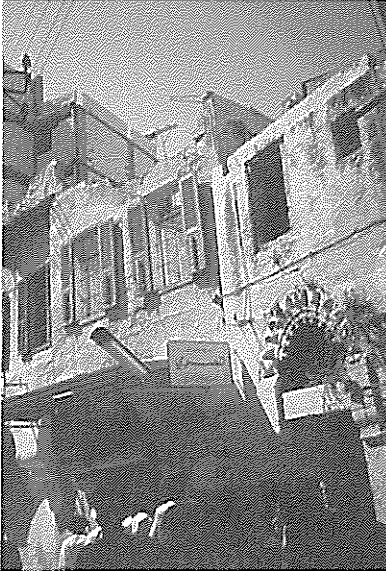
Abb. 4 / Verfallende Bausubstanz / Foto: Langendörfer
